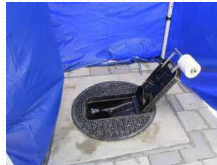
マンホールトイレの事例
