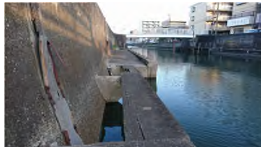
図7 元町地域の老朽化箇所
