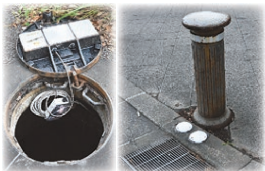
マンホールアンテナ
