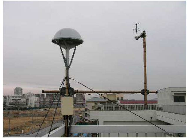
右：航空機接近検知識別センサー
