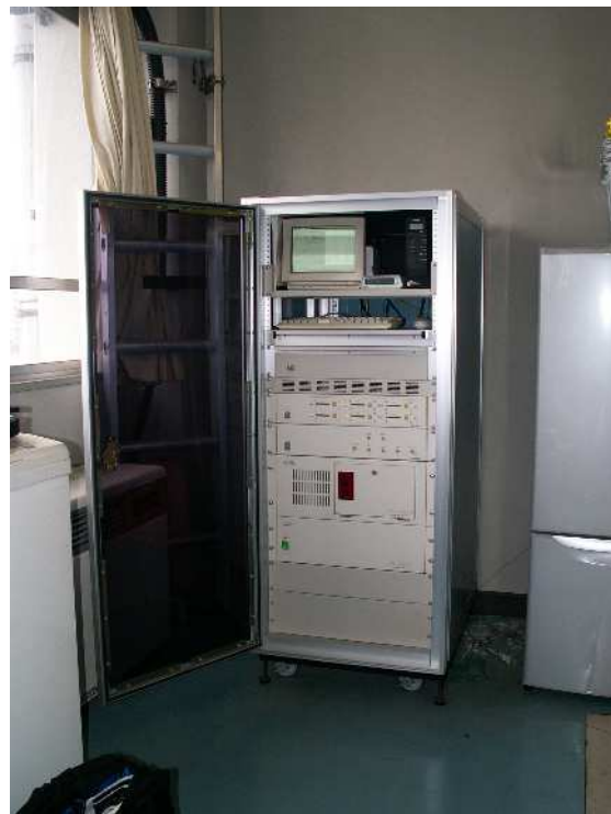
航空機騒音自動測定装置本体
